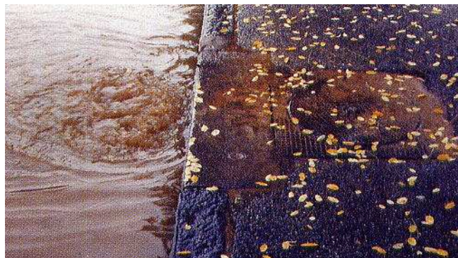
Exemple d'un débordement de réseau dans les Hauts-de-Seine
