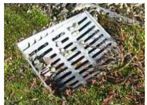
Crapaudine d'évacuation de toiture en mauvais état
