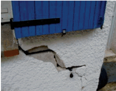
Figure 3 : Conséquence du retrait gonflement de l'argile sur une habitation (source : www.loire-atlantique.equipement.gouv.fr )
