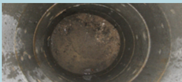
Intérieur d'un puits d'infiltration
