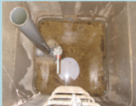
Accessibilité de la vanne de vidange et de la surverse d'un bassin
