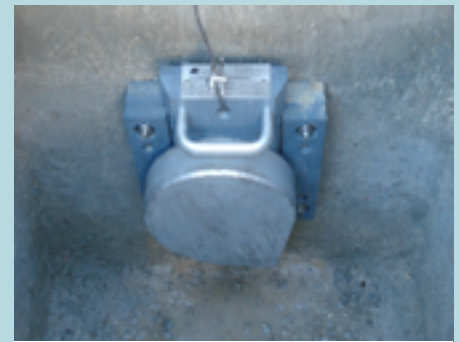
Régulateur à effet siphon avec rail de positionnement
