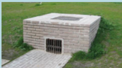
Accessibilité du trop plein d'un bassin
