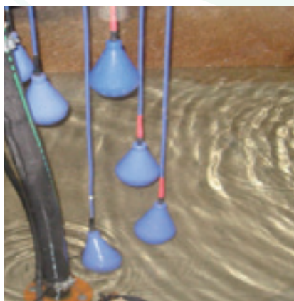
Poires de niveau : niveau d'eau stagnant en période de temps sec
