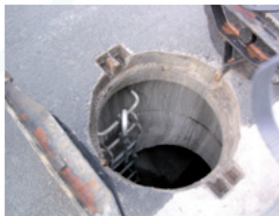
Pompes accessibles depuis un regard d'accès dégagé et sécurisé
