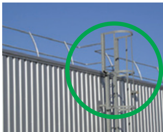
Accès technique sécurisé
